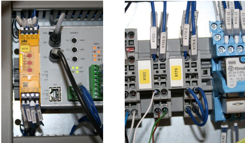
Abbildung 3: Sicherheitsschaltgerät und Klemmen für Sicherheitseinrichtung im Schaltschrank
