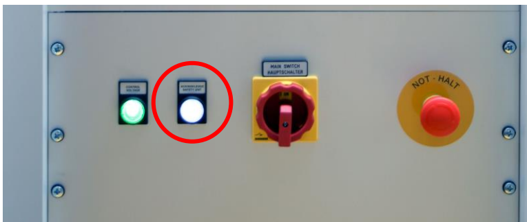
Abbildung 4: Taster zur Quittierung der Sicherheitsüberwachung am Schaltschrank
